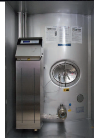
Schaltschrank Massiver, offener Schaltschrank aus Nirostahl mit eingebauter MIII-Steuerung.
